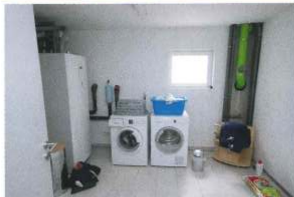
Für die Heizungs- und Haustechnik, aber auch die Wäsche der mehrköpfigen Familie ist in den schön ausgebauten Kellerräumen mehr als genug Platz.
