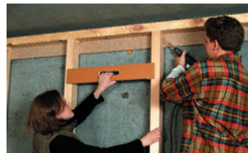
Step 2: Die vertikalen Hölzer werden als Unterkonstruktion mittels einer Lehre, passend zu den lieferfähigen Dämmstoffbreiten, angeschraubt.
